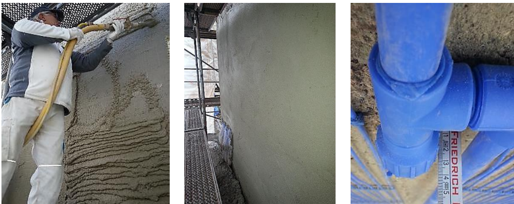
Abbildung 23: Maschinelles Überputzen der Kapillarrohrmatten (links), Ansicht der glattgestrichenen Fassade nach dem Überputzen (Mitte) und Foto der Einschweißsättel mit Tauchhülsen für die Temperatursensoren an der Feldtestfläche als „dickstes Bauteil“ der Temperierungsebene
