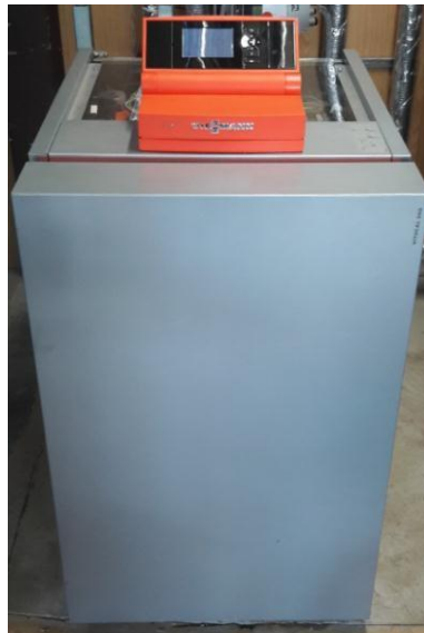
Abbildung 93: Eingesetzte Wärmepumpe Vitocal 300-G, Firma Viessmann GmbH & Co. KG
