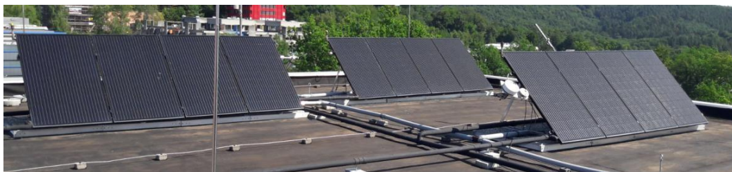
Abbildung 91: Lage der PVT auf dem Dach des Gebäude C3.1 der Universität des Saarlandes, Saarbrücken
