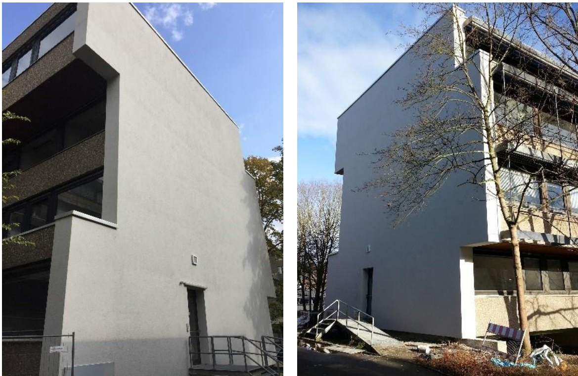
Abbildung 25: Fotos der Fassade nach Abschluss der Sanierungsarbeiten (in der Mitte der Fassade über der Tür ist die Außenklappe der aLT-Feldtestfläche zu erkennen)
