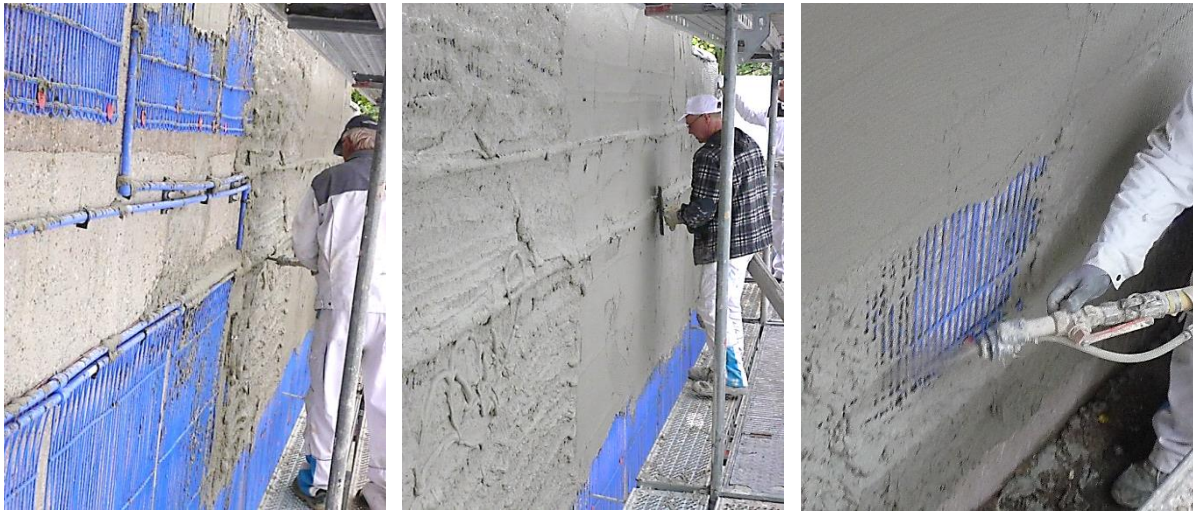
Abbildung 22: Maschinelles Aufbringen des Unterputzes auf die Kapillarrohrmatten (links) und manuelles Glattstreichen der Putzschicht (Mitte und rechts)
