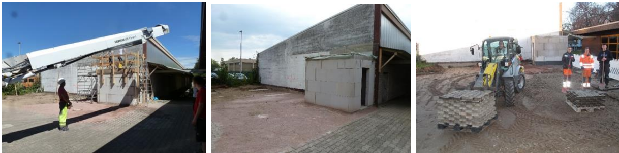
Abbildung 7: Baufortschritt bezüglich der Vorbereitung der Musterfassade bei KOMZET BAU BÜHL [Bildquelle: KOMZET BAU BÜHL]
