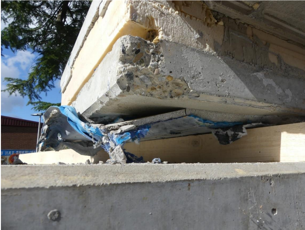
Abbildung 14: Abplatzungen an den Betonkanten
