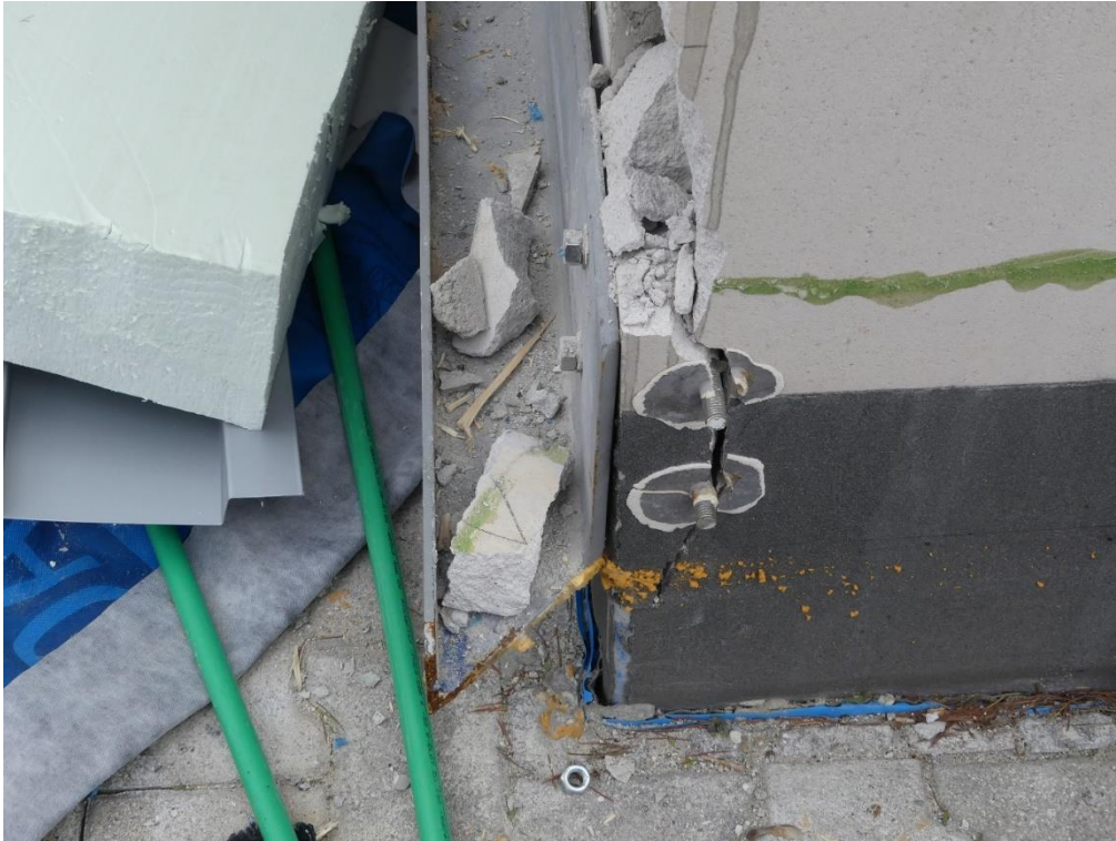
Abbildung 10: Beschädigung am Mauerwerk
